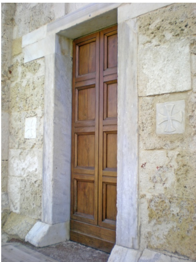
Fig. 6 - PORTO TORRES - Basilica di San Gavino, uno degli ingressi sul fianco nord-occidentale: un blocco in marmo proconnesio reca un marchio (foto A. Teatini)
